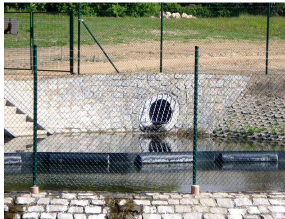
Regenrückhaltebecken in Lütjensee
