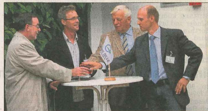
Trittaus Bürgermeister Walter Nussel, Projektingenieur Fred Urban, Verbandsvorsteher Harry Gehrken und der Geschäftsführer des Klärwerks Arnd Wendland setzten das BHKW in Betrieb. Foto: B. Piper
